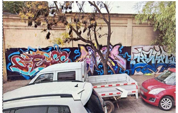
El muro, construido aproximadamente en 1882, conecta simbólicamente el Hospital San José con el Cementerio General a través de los portales Limay y Arriarán, y presenta daños de erosión, humedad y pérdida de ladrillos.
